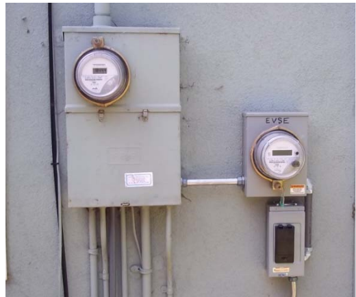
Existing meter / sub-meter
